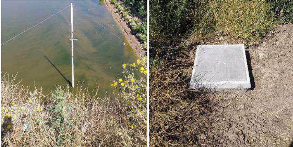
Figura 4-1: Regla y cámara testigo en laguna de acumulación
